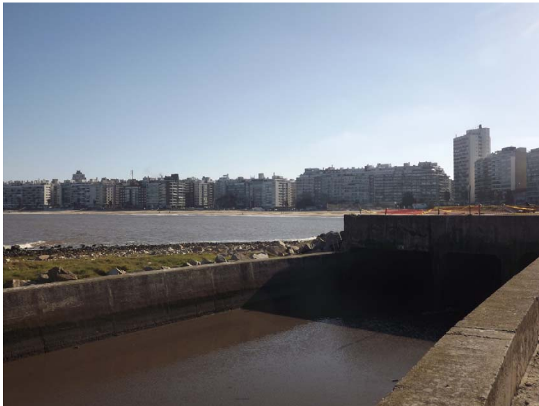
Figura 49. Fotografía del vertedero Pocitos. Elaboración propia (2015).
